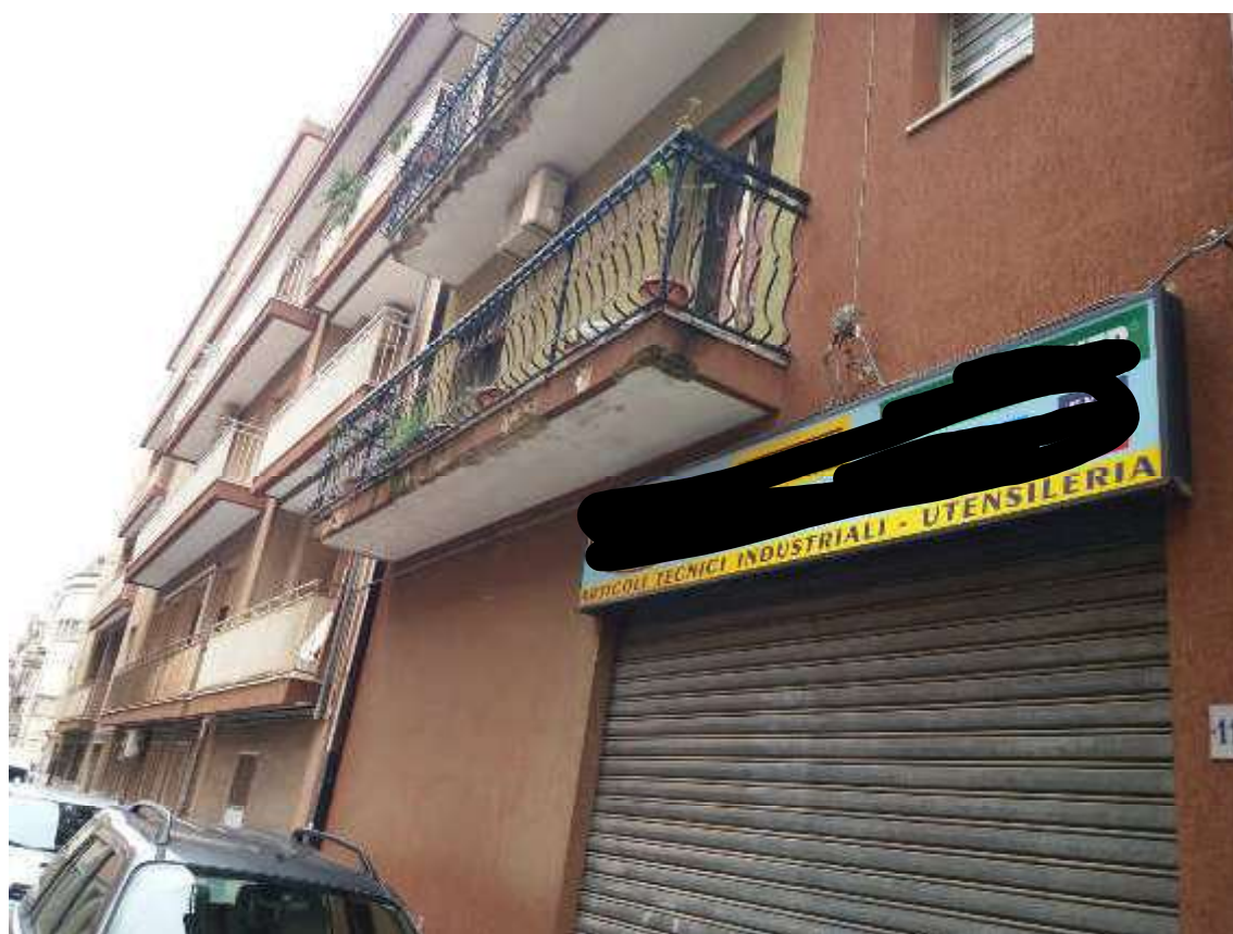
Particolare frontalino ammalorato
