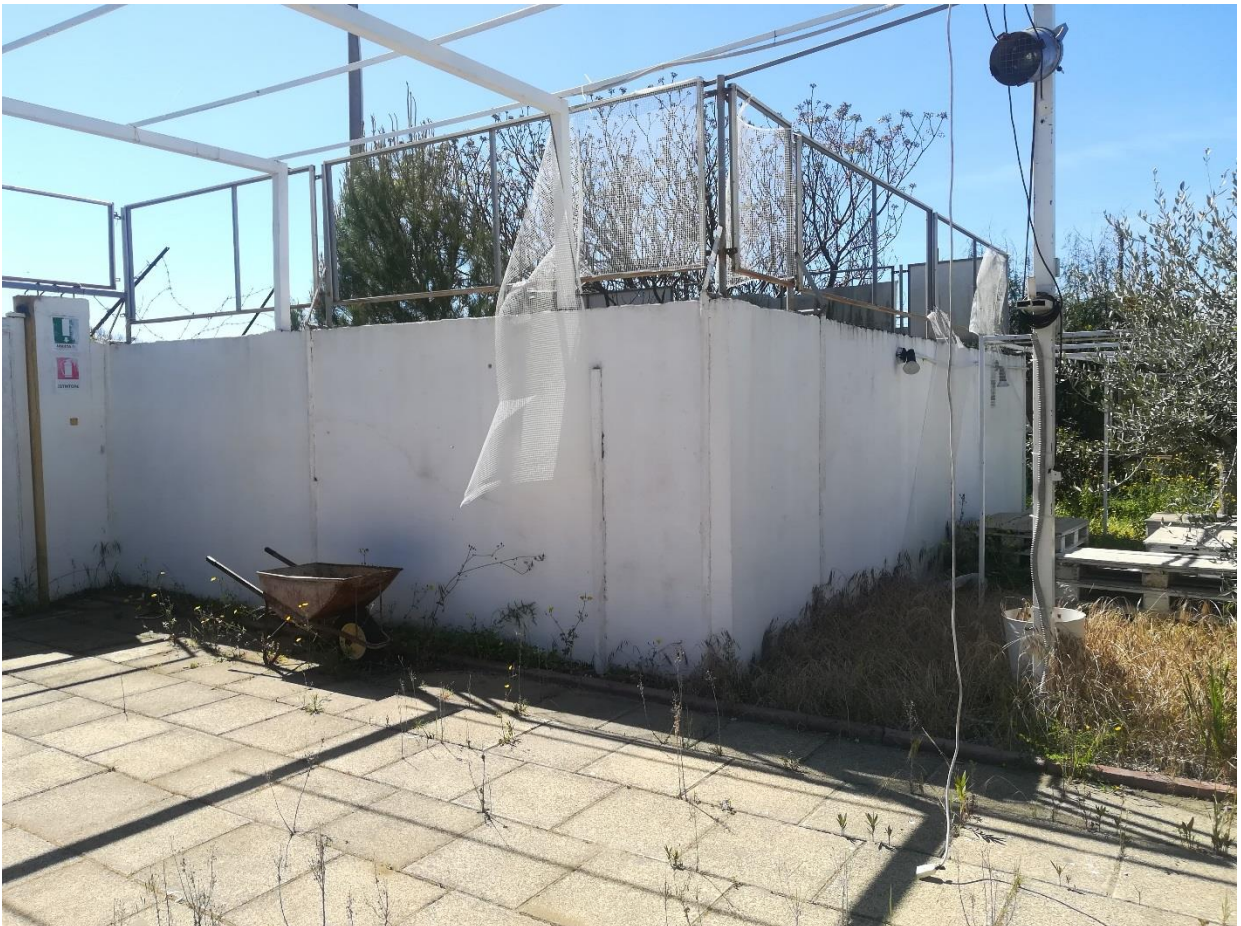
32. Muretto di recinzione della p.lla 879 di proprietà aliena
