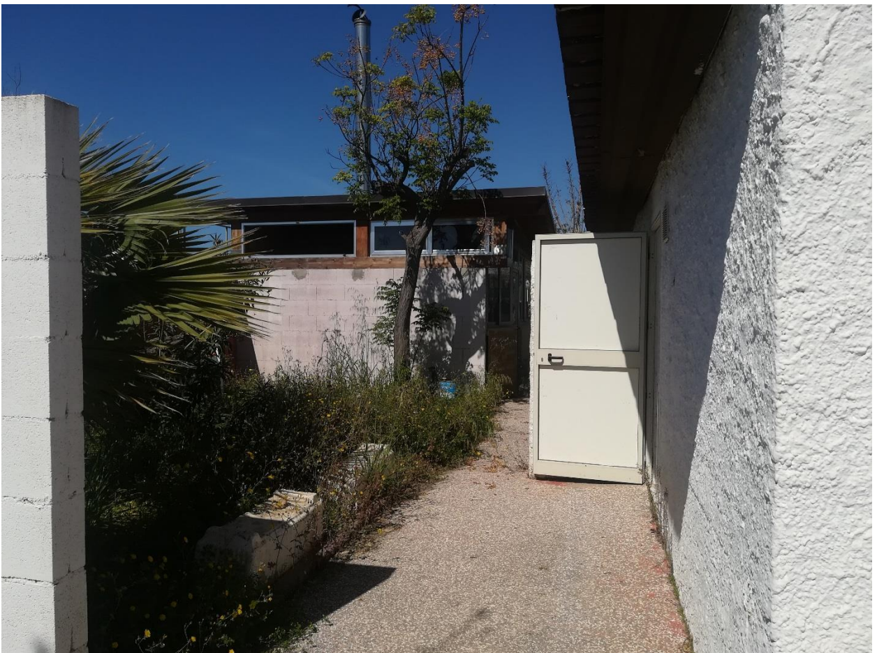
22. Ingresso ai servizi igienici della discoteca
