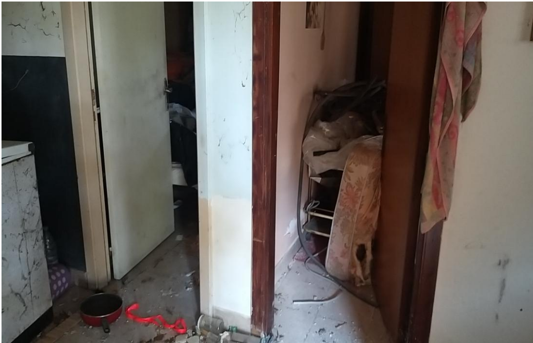
FOTO 18 – Vista interno fabbricato rurale p.lla 473 - Inagibile
