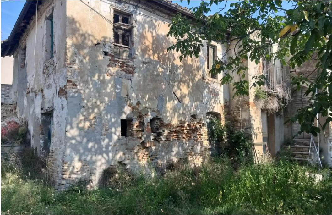
FOTO 3 – Vista lato est fabbricato rurale p.la 470 - Diruto
