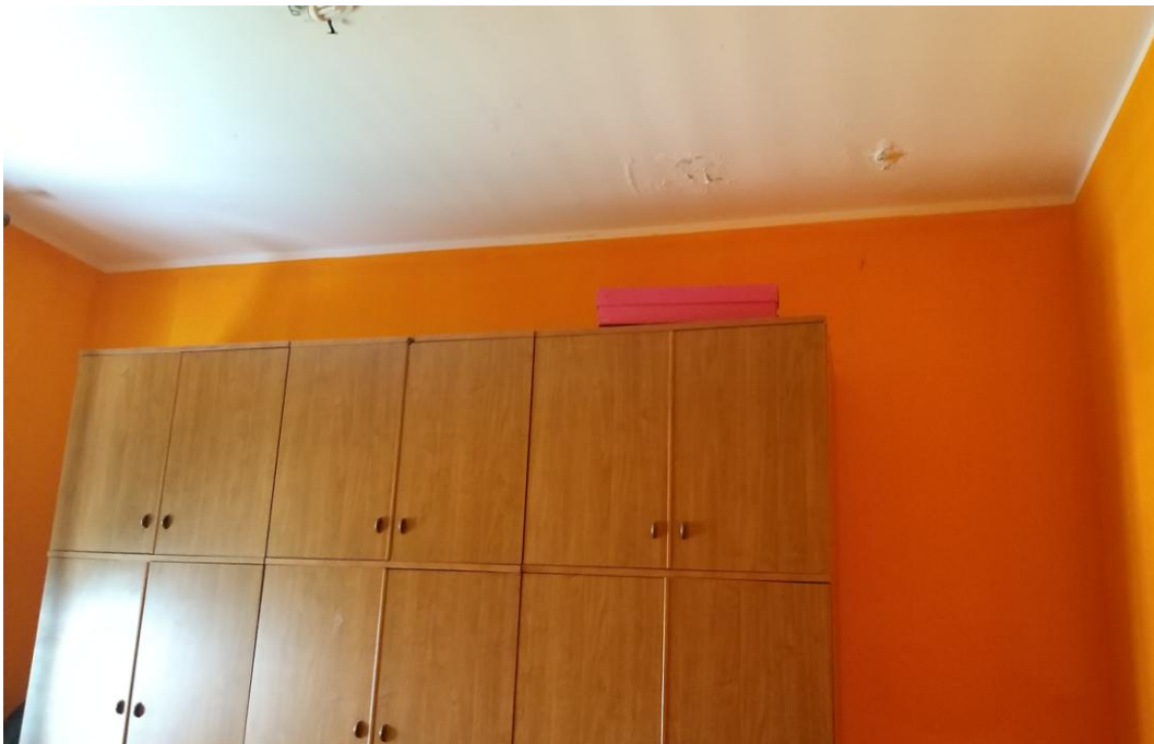
FOTO 45 – Vista zona notte Appartamento P.1° - Segni infiltrazioni d'acqua.
