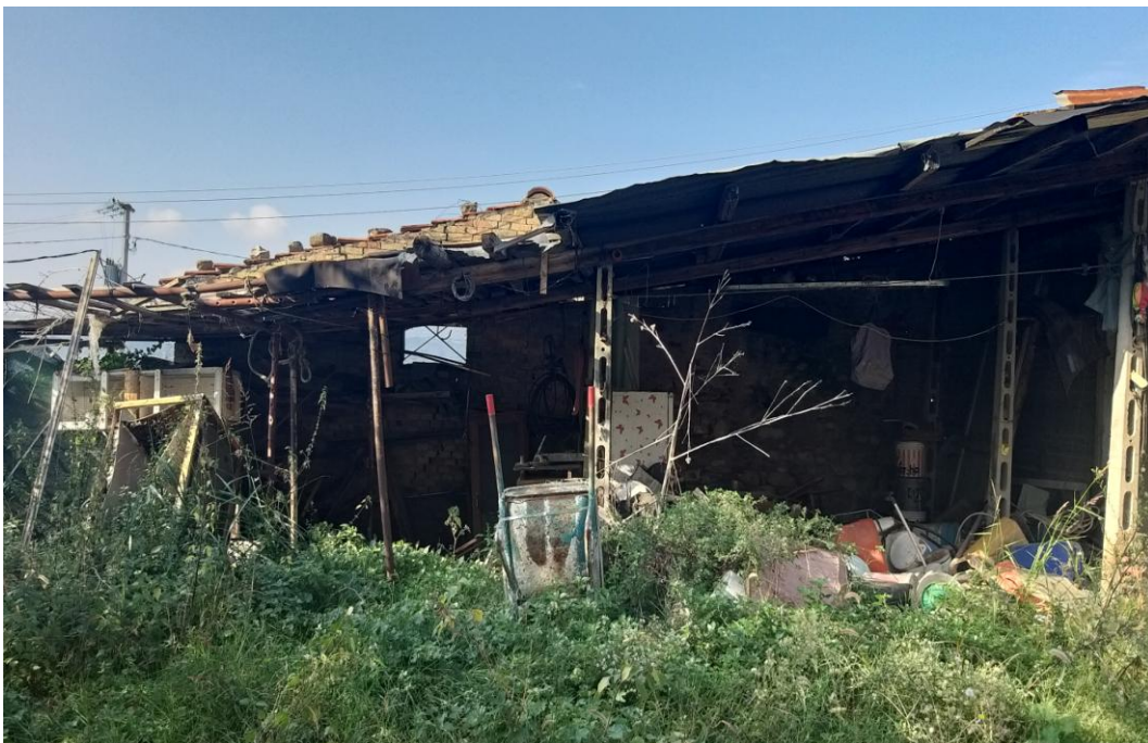
FOTO 14 – Vista tettoia ricadente in parte su p.lla 477 e parte area pubblica.
