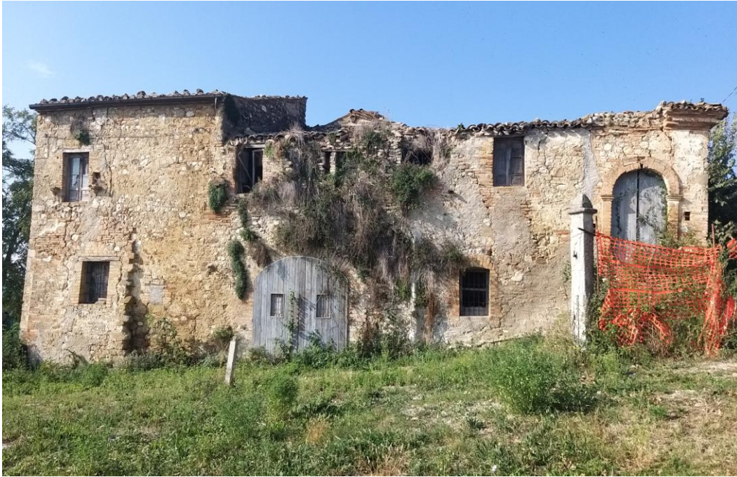
FOTO 1 – Vista lato est fabbricato rurale p.lla 470 - Diruto
