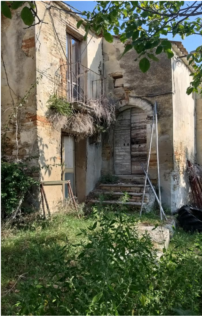
FOTO 5 – Vista ingresso porzione fabbricato rurale p.lla 470 sub 2, civico 5 – Diruto.
