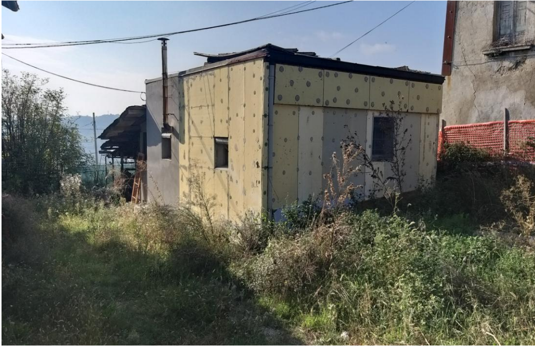
FOTO 11 – Vista fabbricato rurale p.lla 473 - Inagibile
