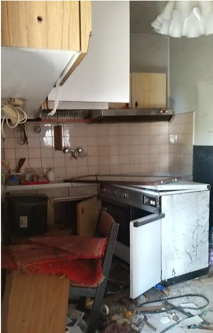
FOTO 17 – Vista interno fabbricato rurale p.lla 473 - Inagibile.
