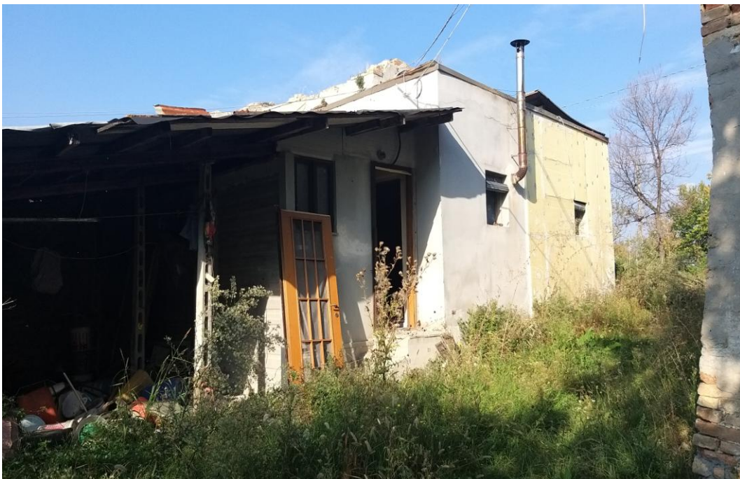
FOTO 12 – Vista fabbricato rurale p.lla 473 - Inagibile
