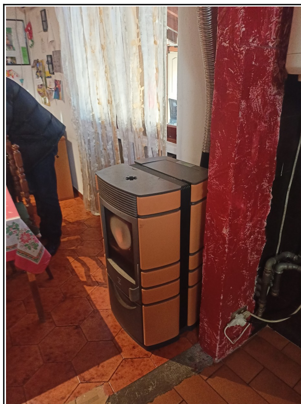
vista stufa riscaldamento
