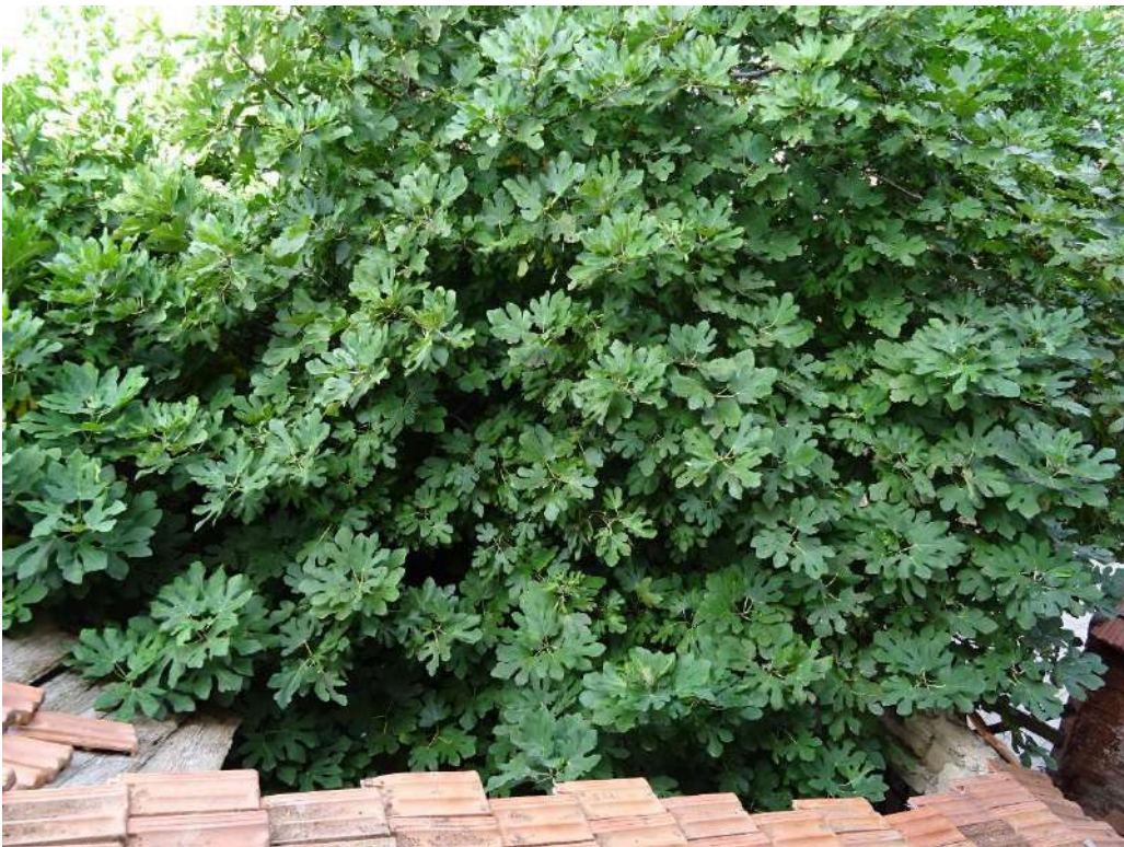
Foto n. 18 Particolare Vegetazione arborea cresciuta interno immobile p.Ila 2484
