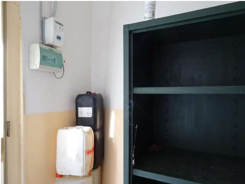
Foto n. 12 Zona ingresso – impianto elettrico
