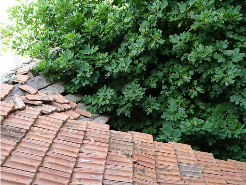
Foto n. 17 Particolare copertura con tetto crollato
