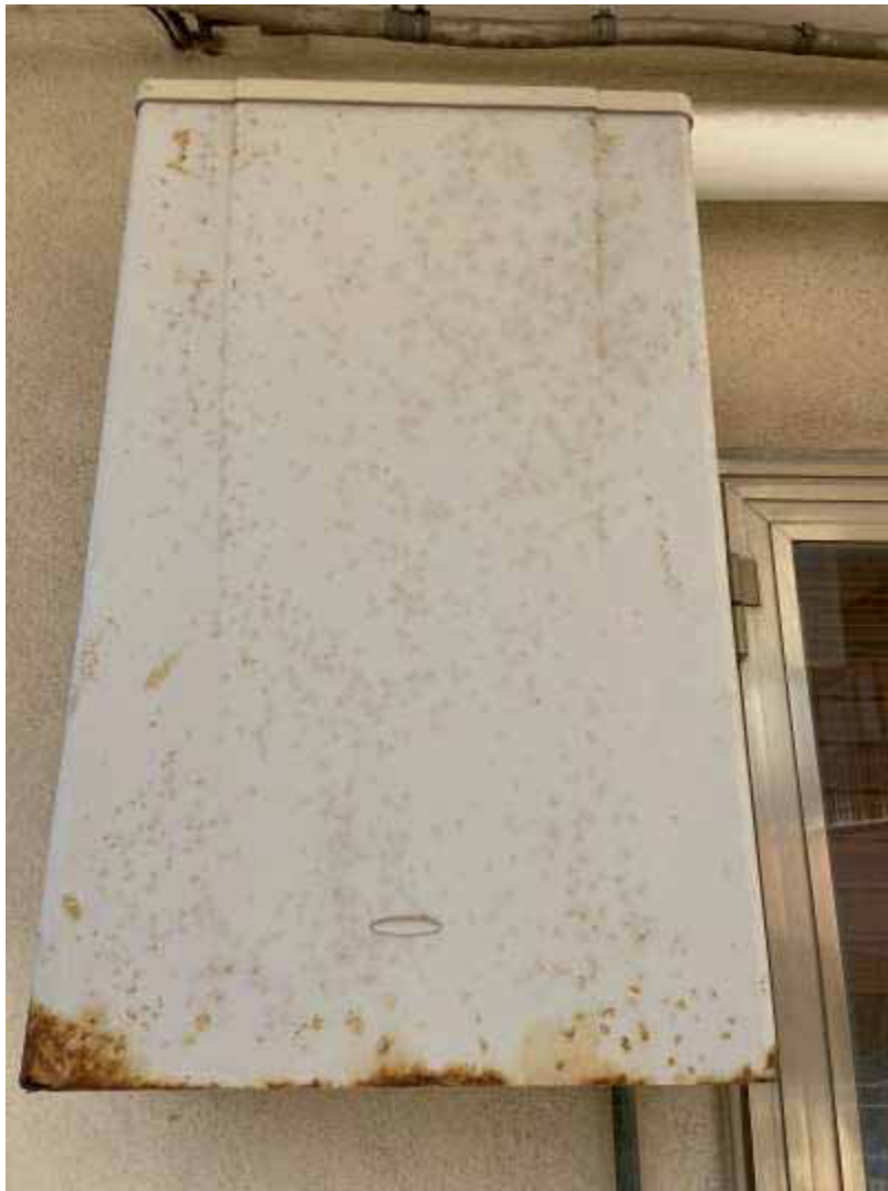
Foto 16) – Caldaia (IMMOBILE A)
