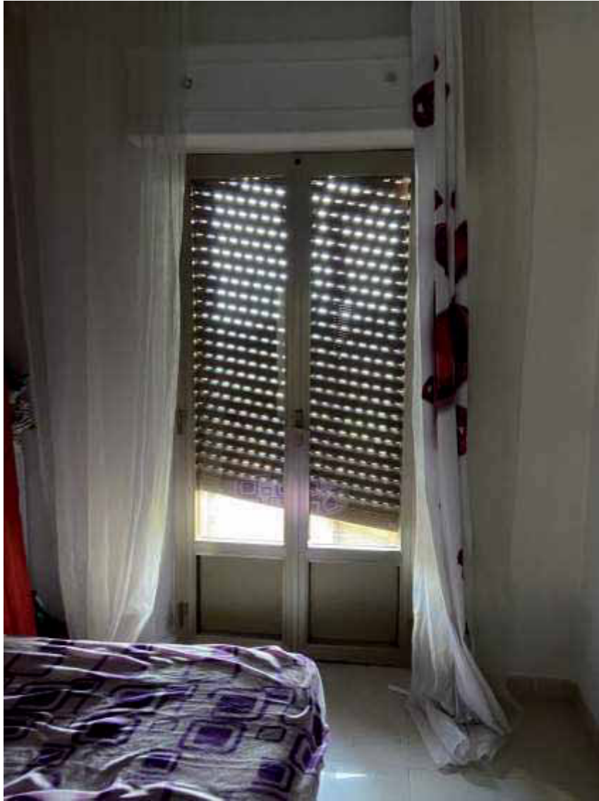
Foto 12) – Vista finestra camera 2 con tapparella rotta ( IMMOBILE A )
