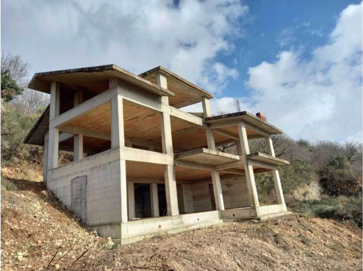
Foto n. 7 – Rustico di villino distinto con il mappale n. 1070, lato anteriore e DX
