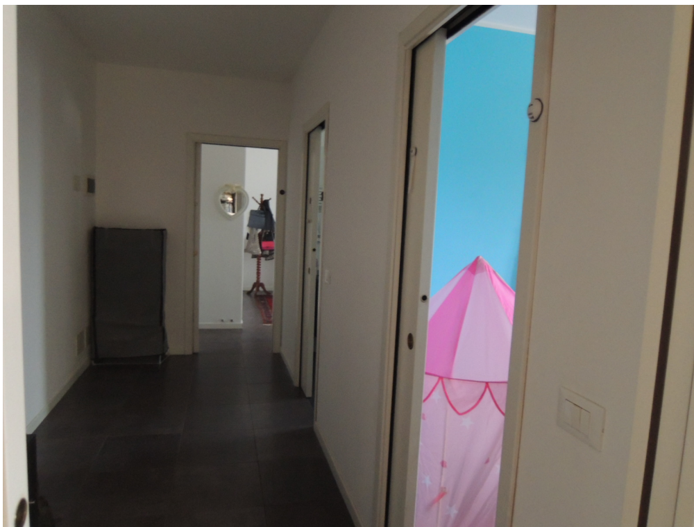
Foto 13 – magazzino piano primo adibito illegittimamente ad appartamento (corpo A)
