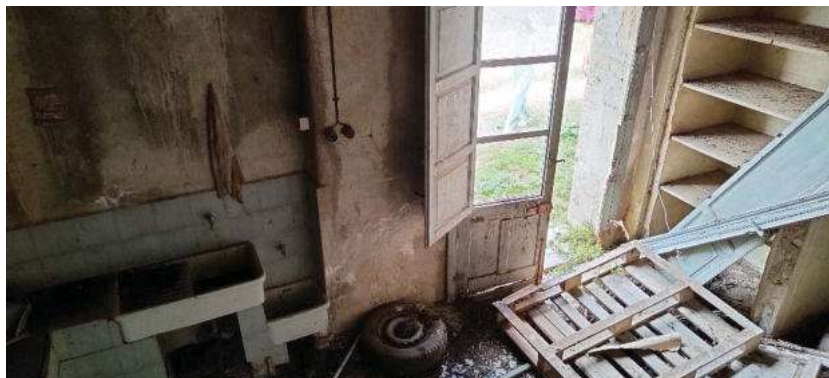
Foto 60 deposito lato nord
