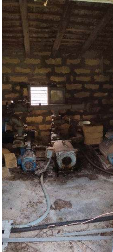
Foto 66 locale tecnico plla 237
