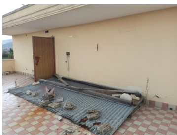
Botola coperta da lamiera
