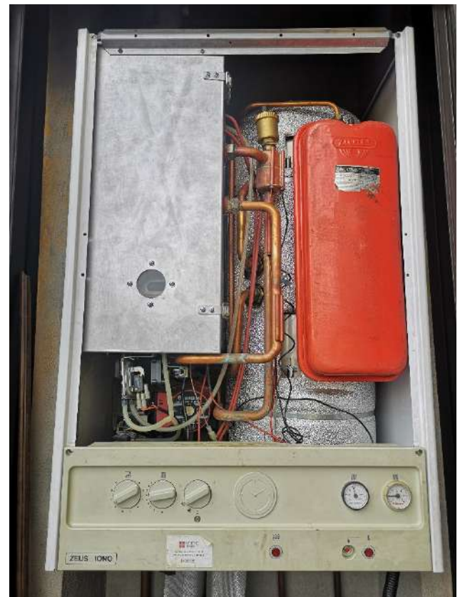
Caldaia (su terrazzo a P1).
