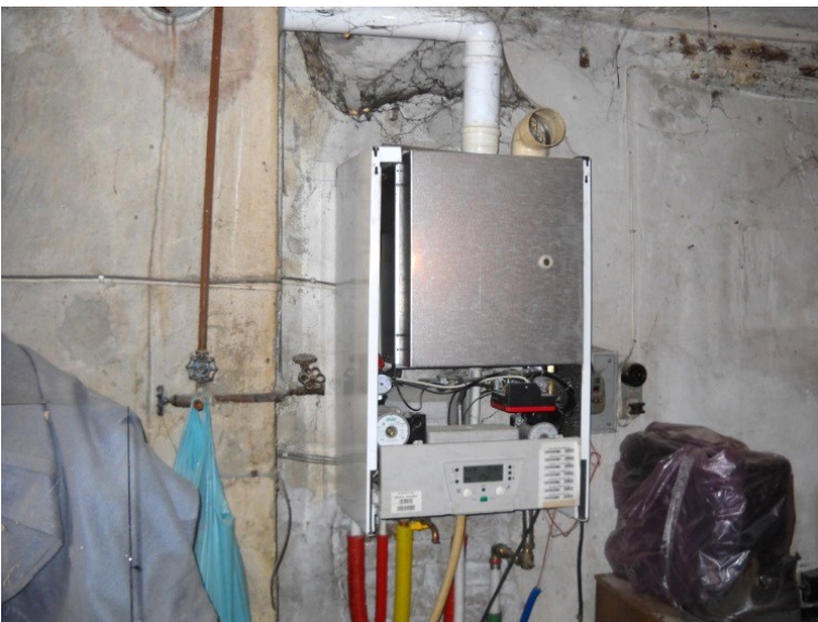
Caldaia nel locale di sgombero piano terreno
