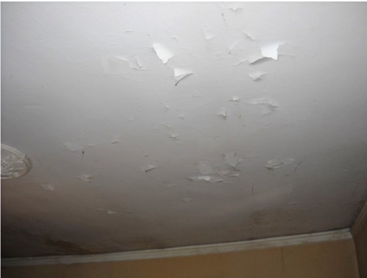
Soffitto ammalorato piano primo
