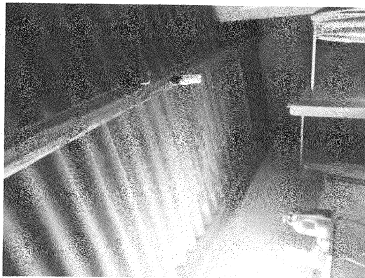
Figure 16: particolare della copertura in eternit nella zona magazzino
