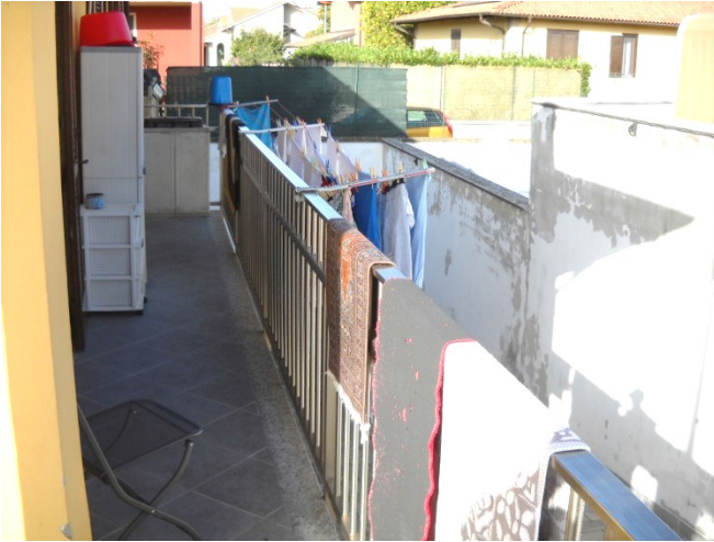
Balcone abusivo lato rampa
