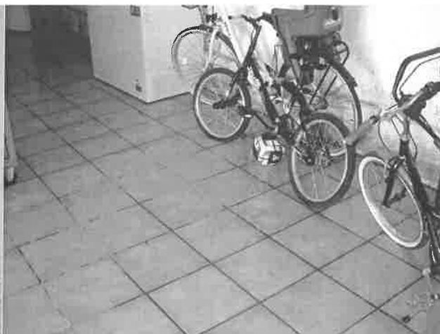
Infiltrazioni lato est piano interrato
