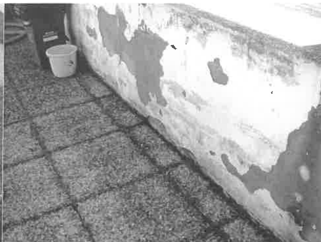
Scrostamento muro di confine lato ovest verso strada
