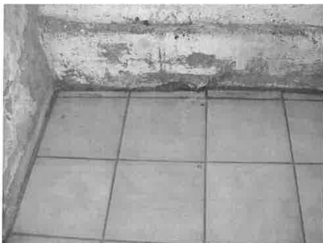
Infiltrazioni lato nord piano interrato
