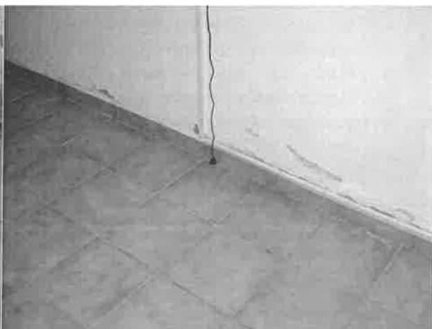
Tracce umidità lato ovest piano interrato
