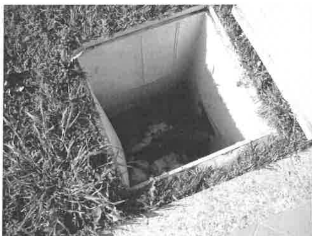
Pozzetto di scolo non collegato con scarico
