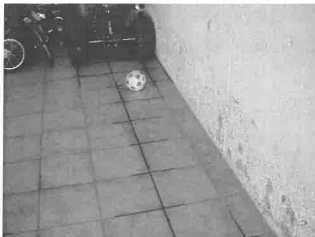
Infiltrazioni lato est piano interrato
