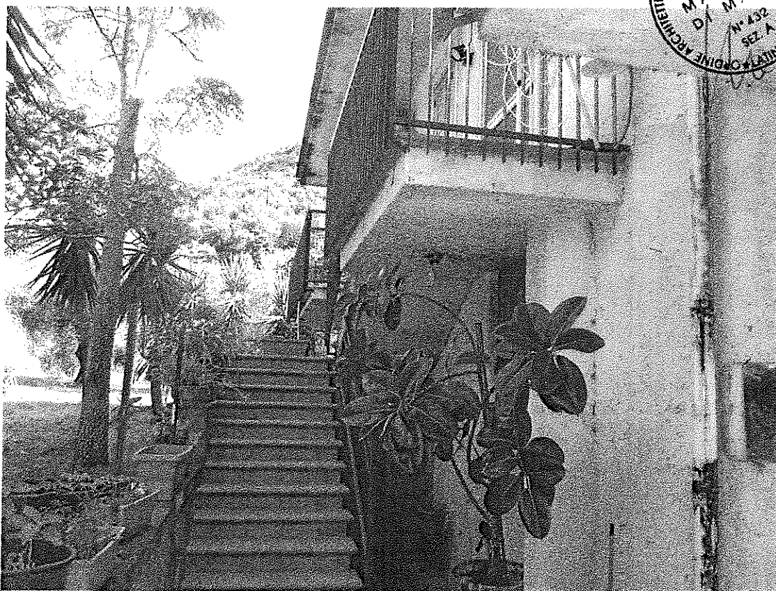
Foto 4 – Particolare rampa di accesso appartamento distinto al sub 3 posto al primo piano
