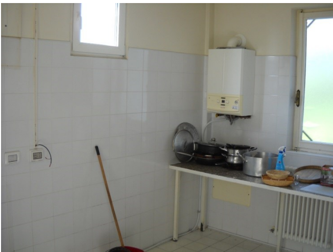
Locale commerciale retro con caldaia (sub.34)
