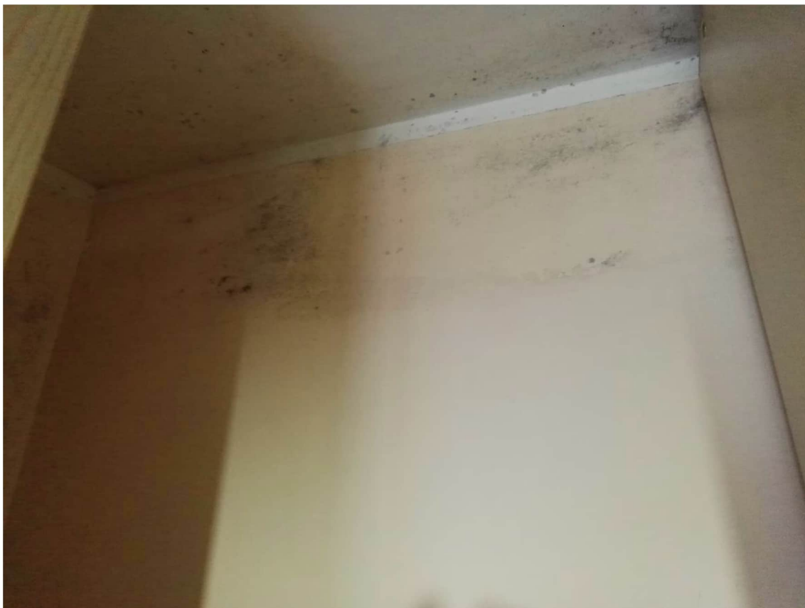
Foto 11 - Lotto Unico: Danni in Camera da Letto;
