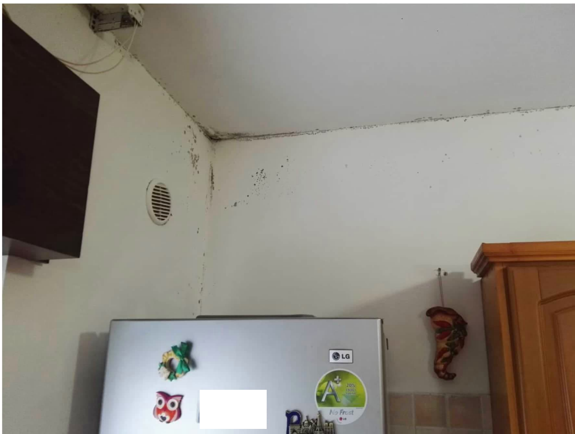
Foto 7 - Lotto Unico: Danni in Cucina;
