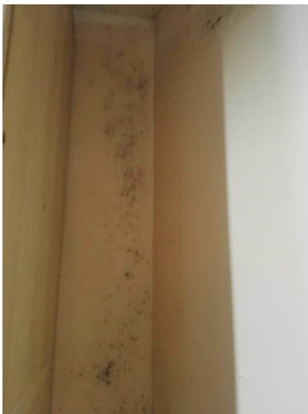
Foto 12 - Lotto Unico: Danni in Camera da Letto;
