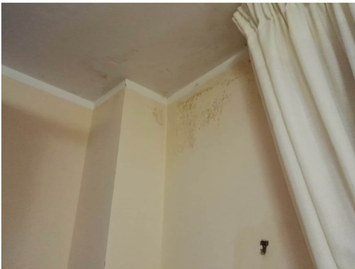
Foto 16 - Lotto Unico: Danni in Camera da Letto;
