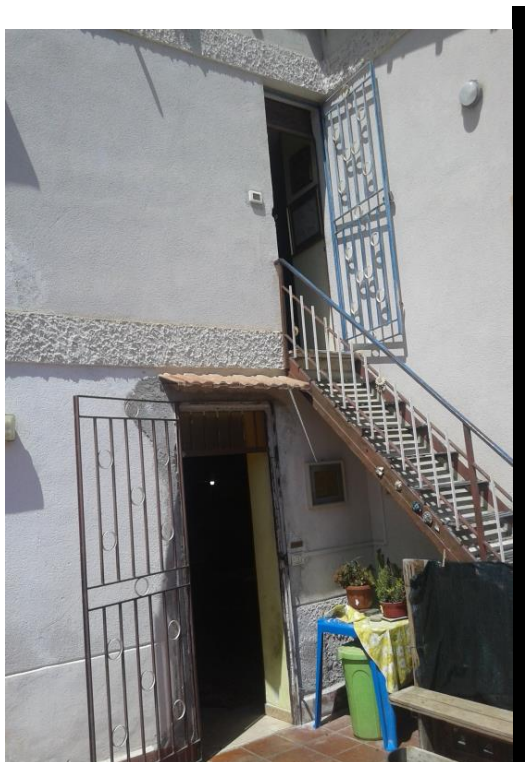
Foto 3: prospetto esterno "ingressi piano terra e primo piani collegati da scala esterna in ferro"
