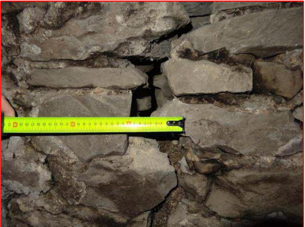
Foto 14 (Particolare della Lesione 2)
