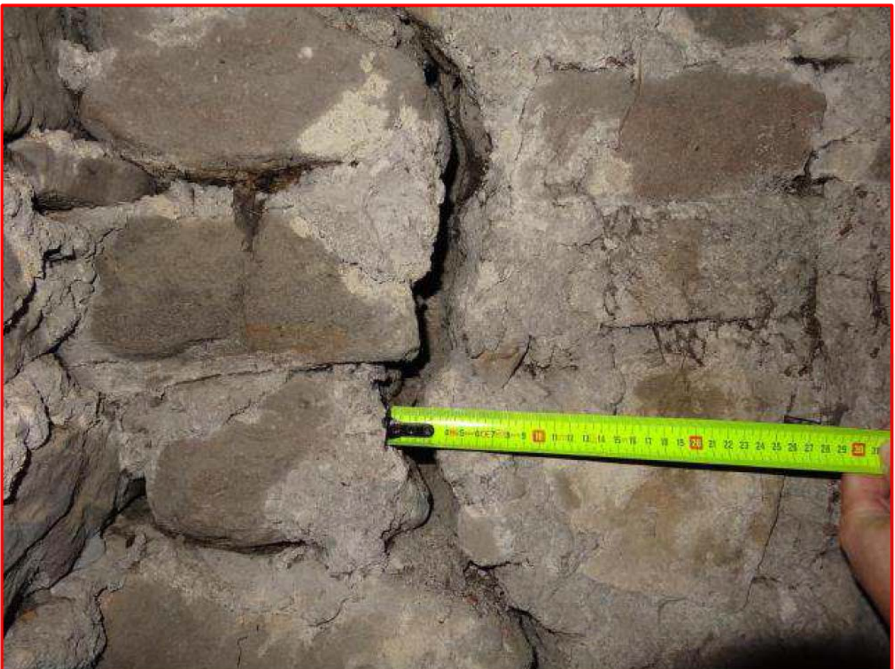
Foto 16 (Particolare della Lesione 3)
