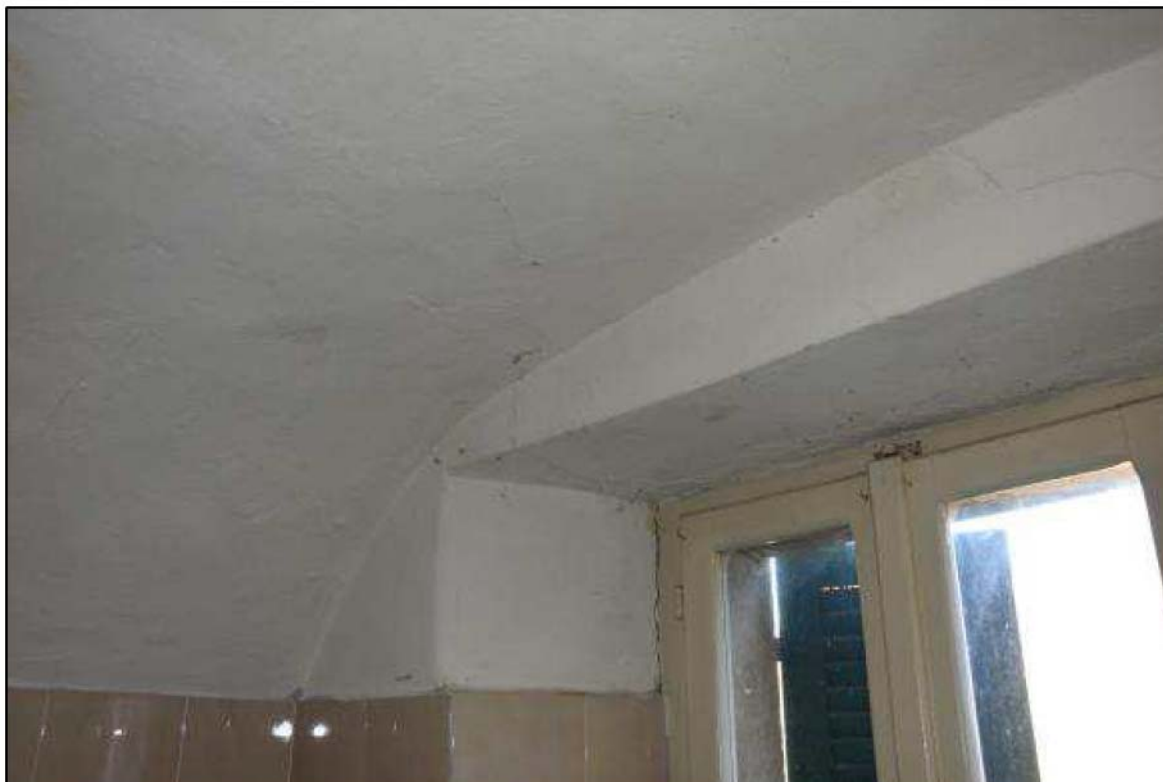
Foto 3 (Corrispondenza interna della lesione 1)
