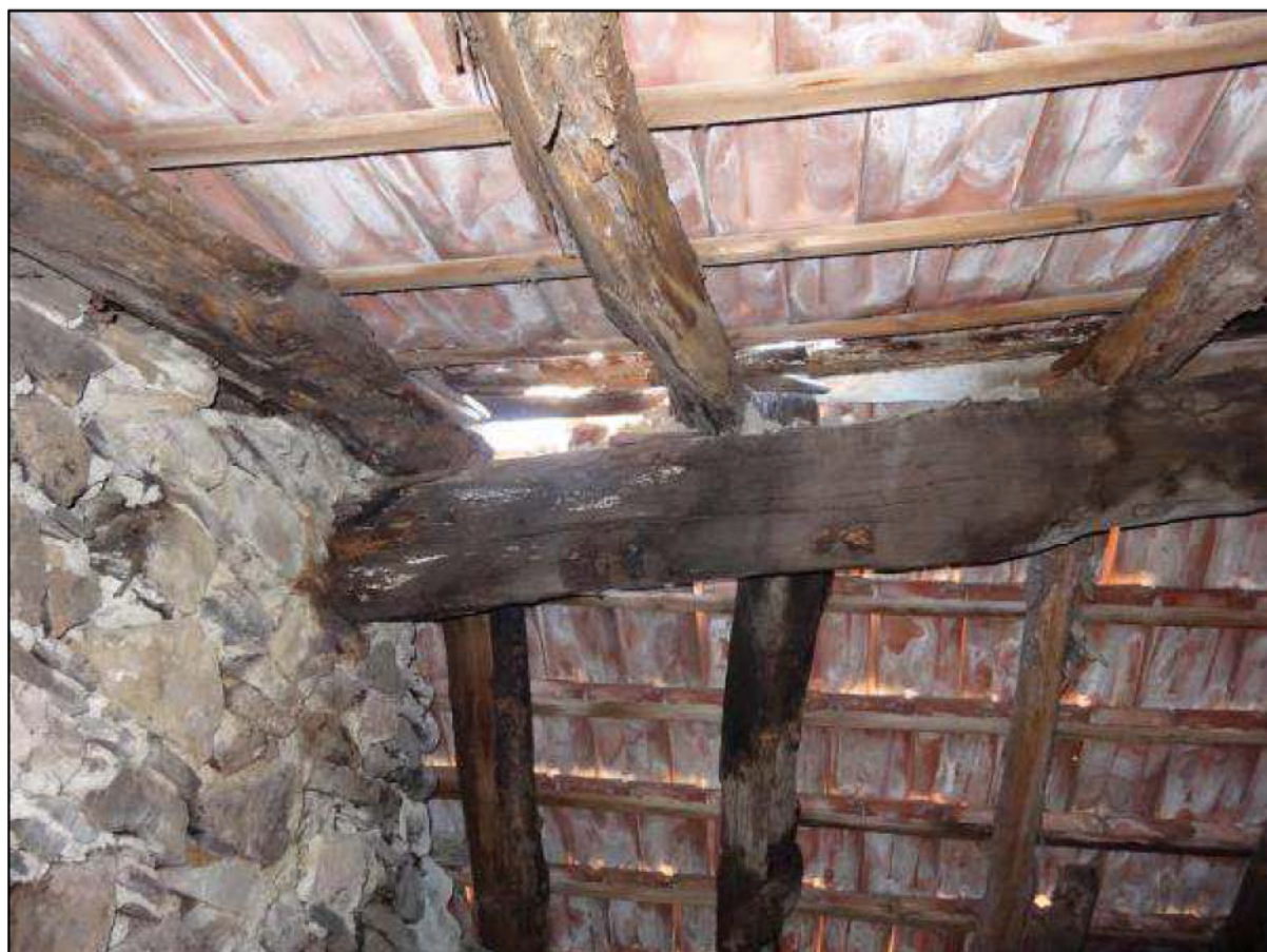
Foto 18 (Avanzata marcescenza della trave di colmo nell'appoggio di Sud-Est)
