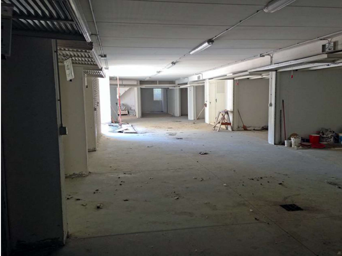
Condominio Glicine – Il piano interrato con i box auto ed i magazzini.
