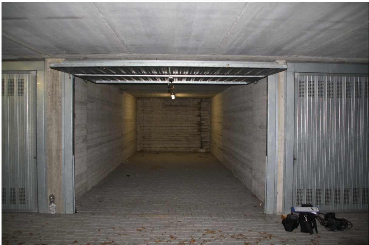
FOTO 4 - INTERNO BOX, SUB 56
