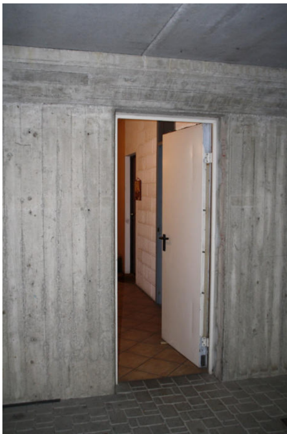
FOTO 4 - PIANO INTERRATO, ACCESSO AL DISIMPEGNO COMUNE DEI LOCALI CANTINA EDIFICIO SCALA C
