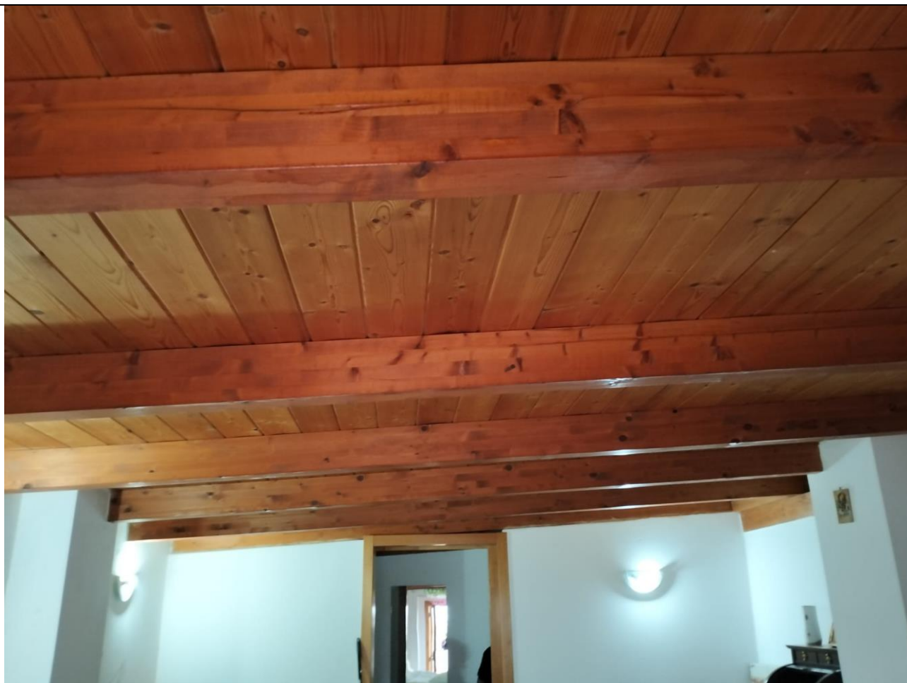
15 – Solaio ligneo realizzato senza autorizzazione
