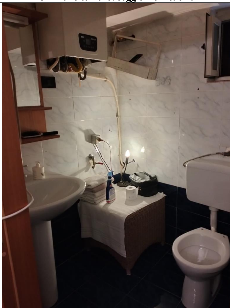
6 – Piano terreno: bagno abusivo da sanare
