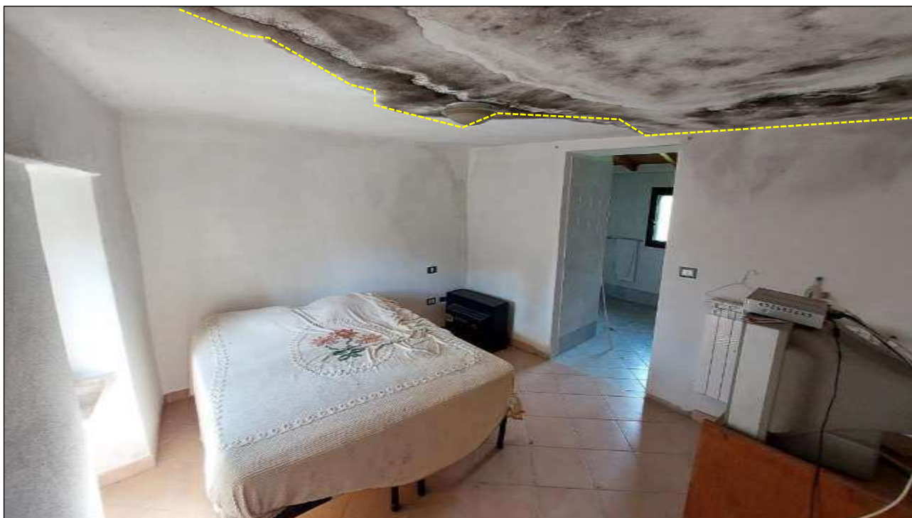
FOTO 34 CAMERA MAPP. 1070 CON EVIDENTI SEGNI DI INFILTRAZIONE DALLA COPERTURA
