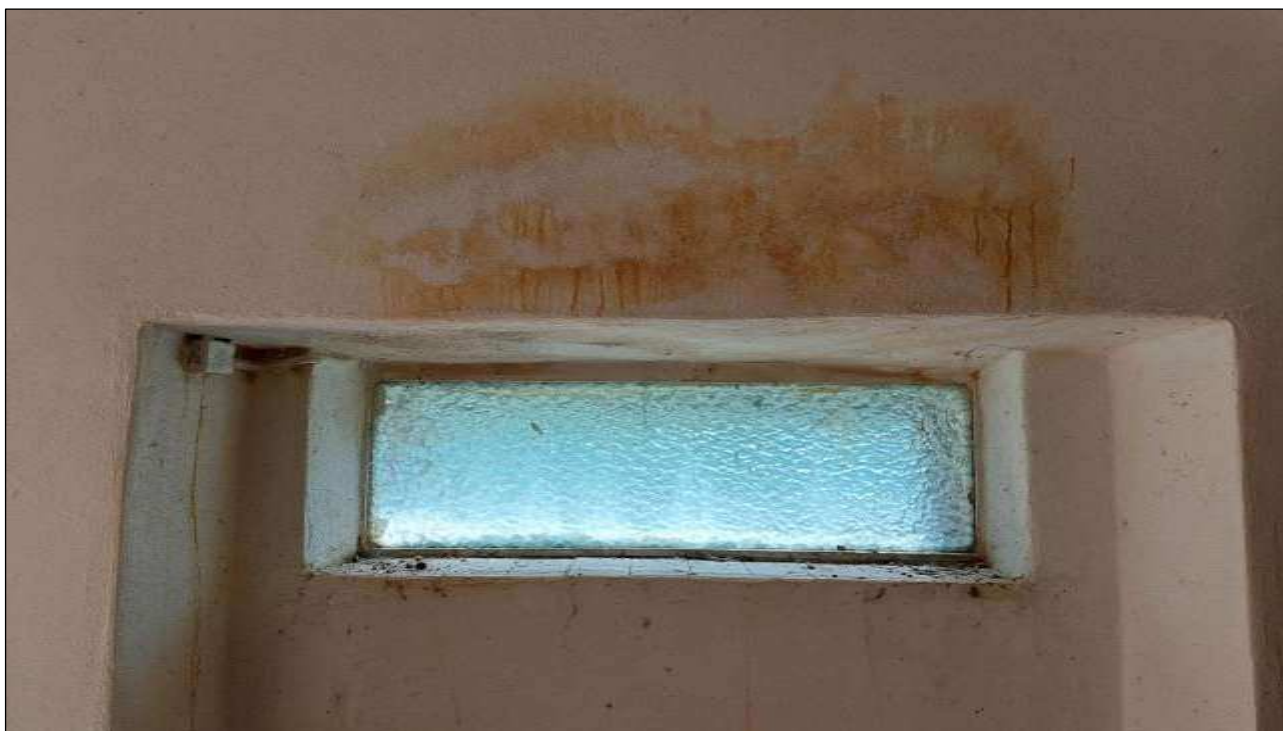
FOTO 22 -part. infiltrazioni acqua
