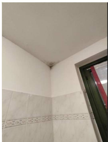
Bagno - segni di umidità
