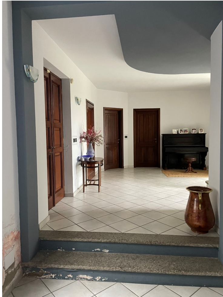
PROBLEMI DI UMIDITA' RILEVATI AL PIANO TERRA INTERNO
