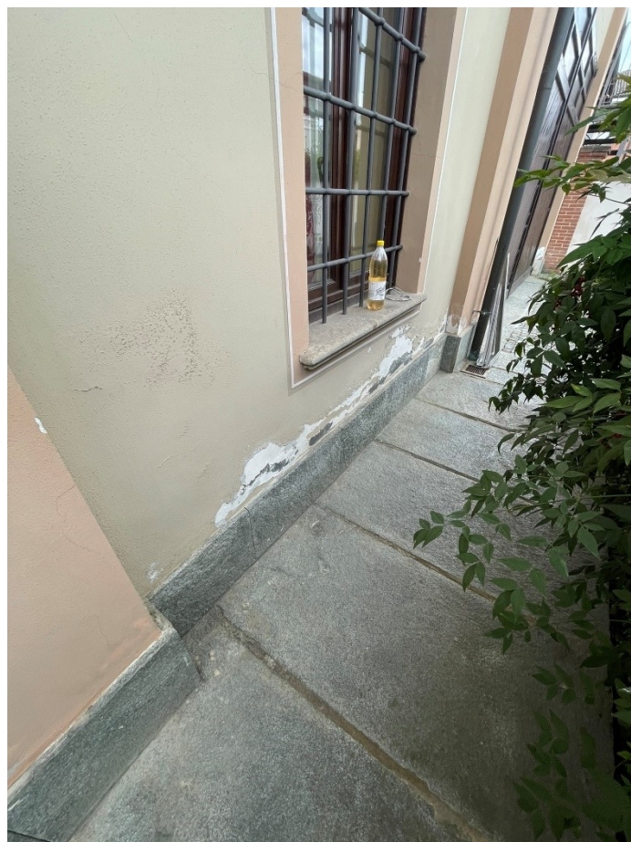
PROBLEMI DI UMIDITA' RILEVATI AL PIANO TERRA ESTERNO
