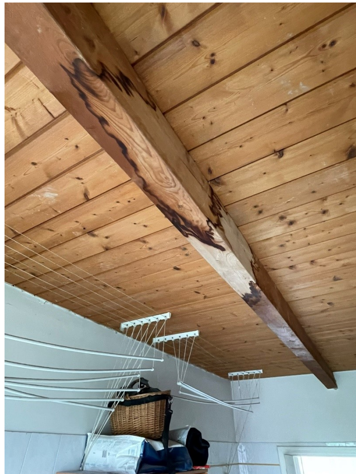
INFILTRAZIONE DAL TETTO IN LAVANDERIA
