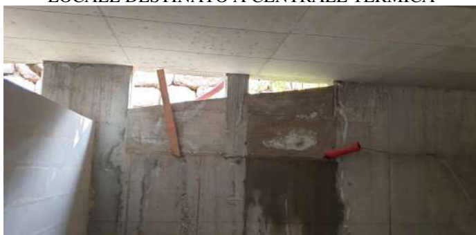
LOCALE DESTINATO A CENTRALE TERMICA
