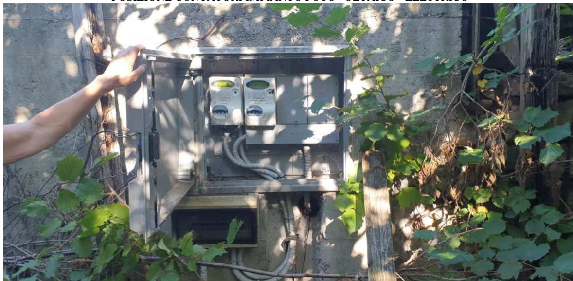
POSIZIONE CONTATORI IMPIANTO FOTOVOLTAICO - ELETTRICO
