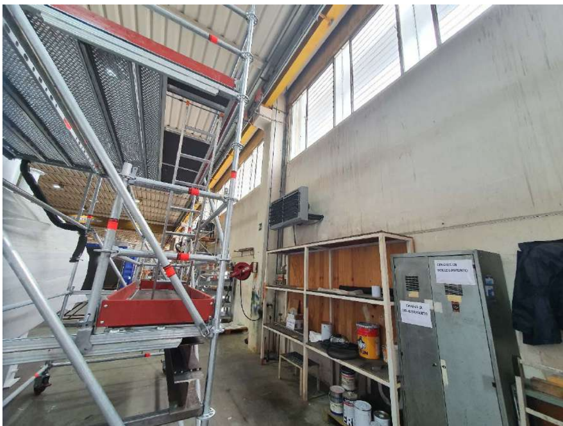
Foto 19 parete interna del capannone con impianto aerotermo
