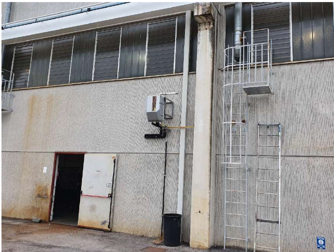
Foto 17 caldaie esterne installate sulla facciata
