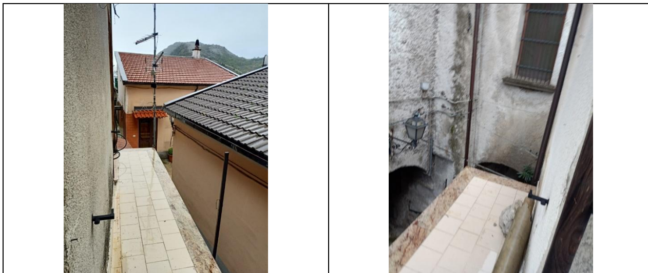
Foto 45-46 – Piano primo: Balconata , priva di ringhiera ancora a predisporci, posta sul prospetto principale lato Via Duomo.
