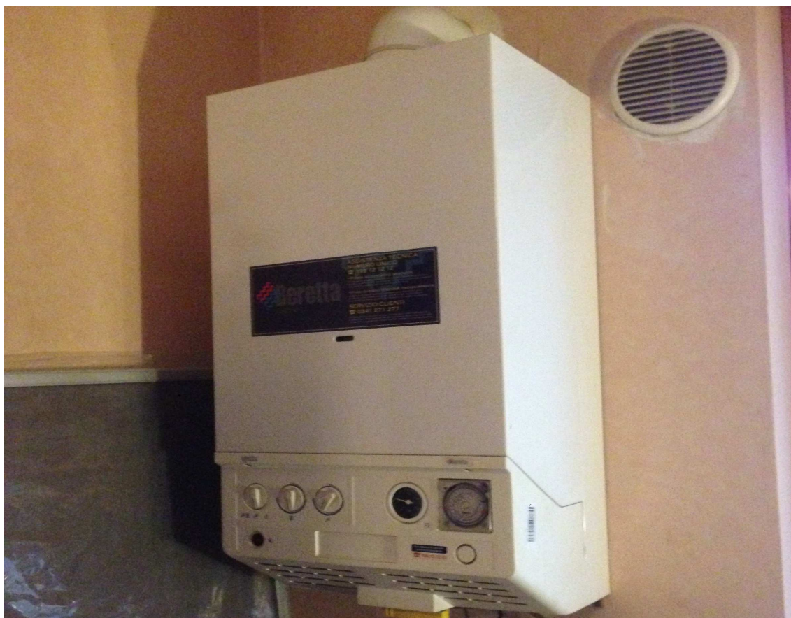
Foto 31 – primo piano, caldaia murale
