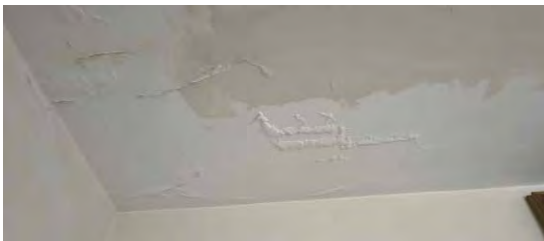
Foto nn. 24 - 26: Nuove infiltrazioni. (sopralluogo del 20/04/2026)
