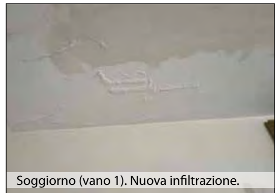
Soggiorno (vano 1). Nuova infiltrazione.
