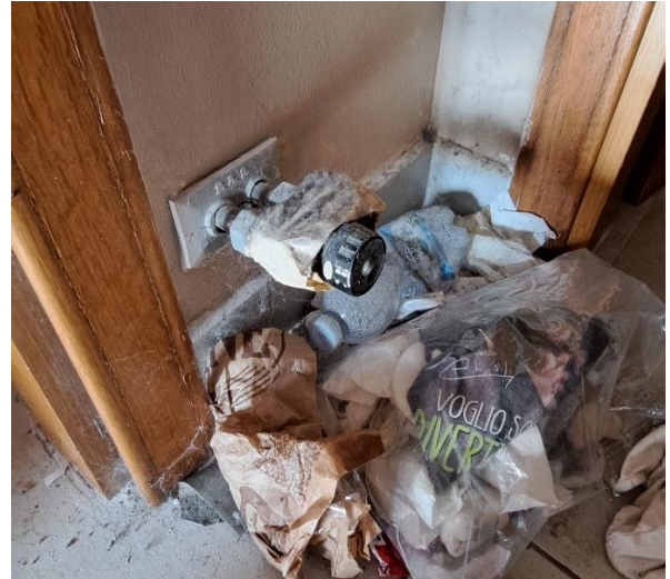
FOTO n.30 – CASA – particolare impianto del gas
