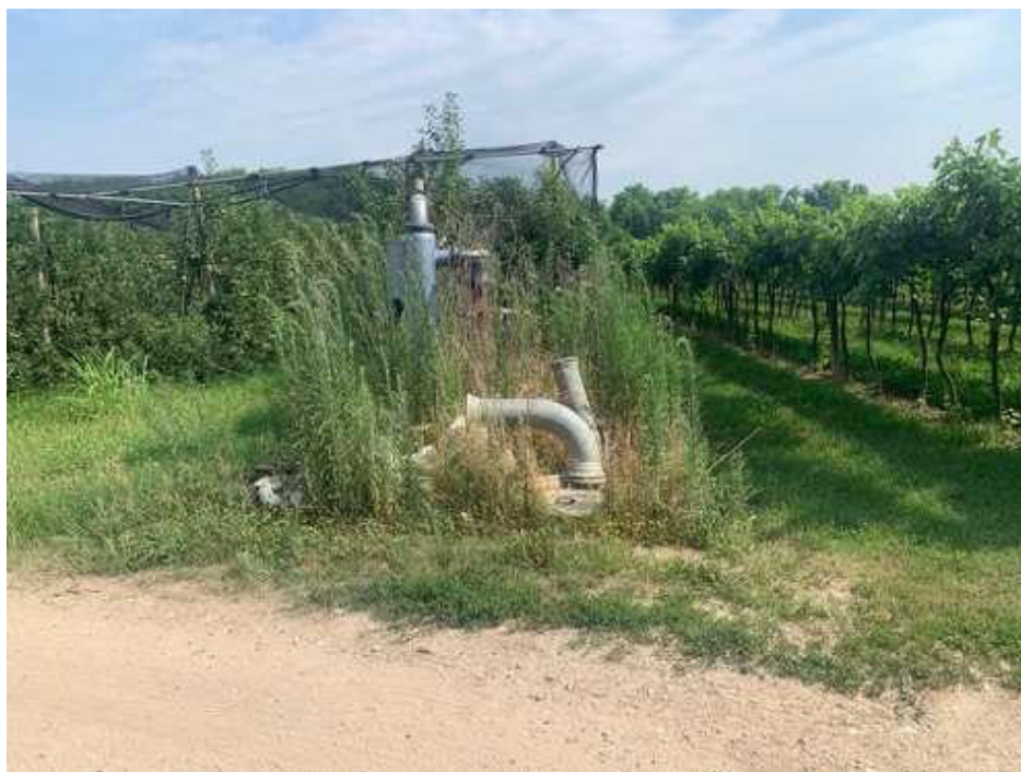
Mapp. 417 – Pozzo irriguo ed impianto pompe di sollevamento attualmente utilizzato per irrigare i mappali 455 – 457 – 417 e 459
