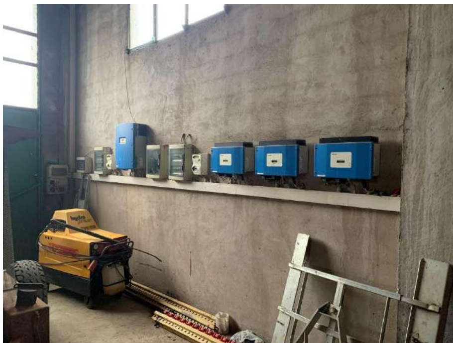
Mapp. 491 - Deposito Attrezzi 2 (fotovoltaico)
