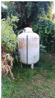
FOTO 50 – BOMBOLONE GPL ESTERNO
