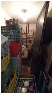
FOTO 43 – LOC. CALDAIA PIANO SEMINTERRATO
