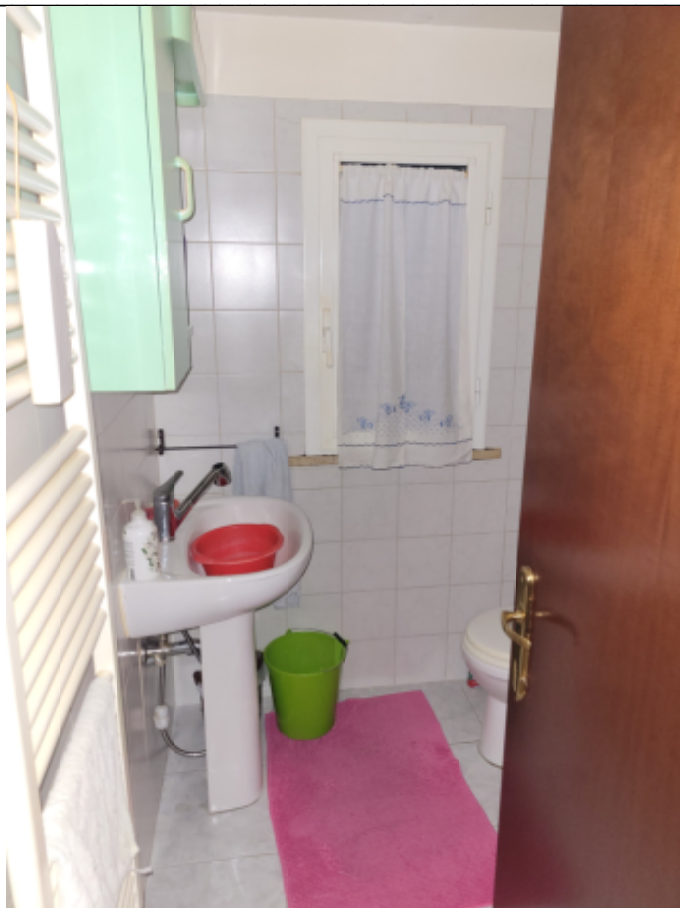
FOTO 5 – Vista del locale wc (locale legittimo ripostiglio)
