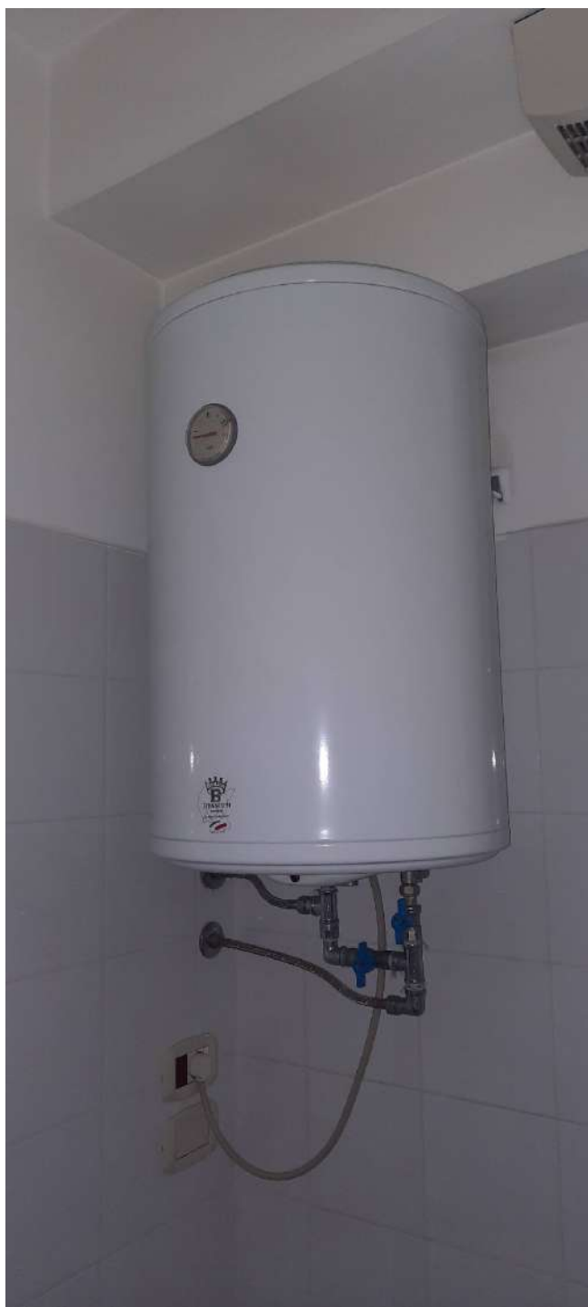
Acqua calda sanitaria (elettrico)
