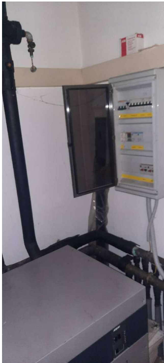
Quadro elettrico di comando generatore
