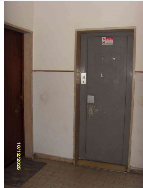
Ascensore – ente condominiale
