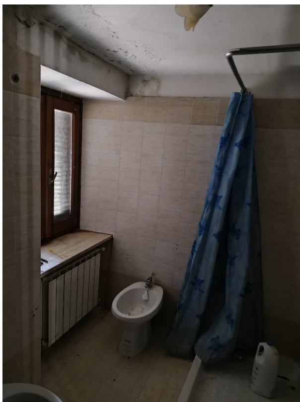
Piano seminterrato - bagno (foto del 25/07/2025)
