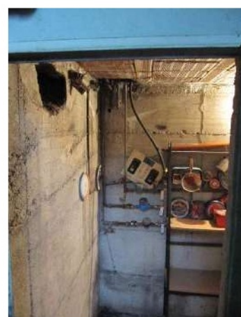
Vista centrale termica
