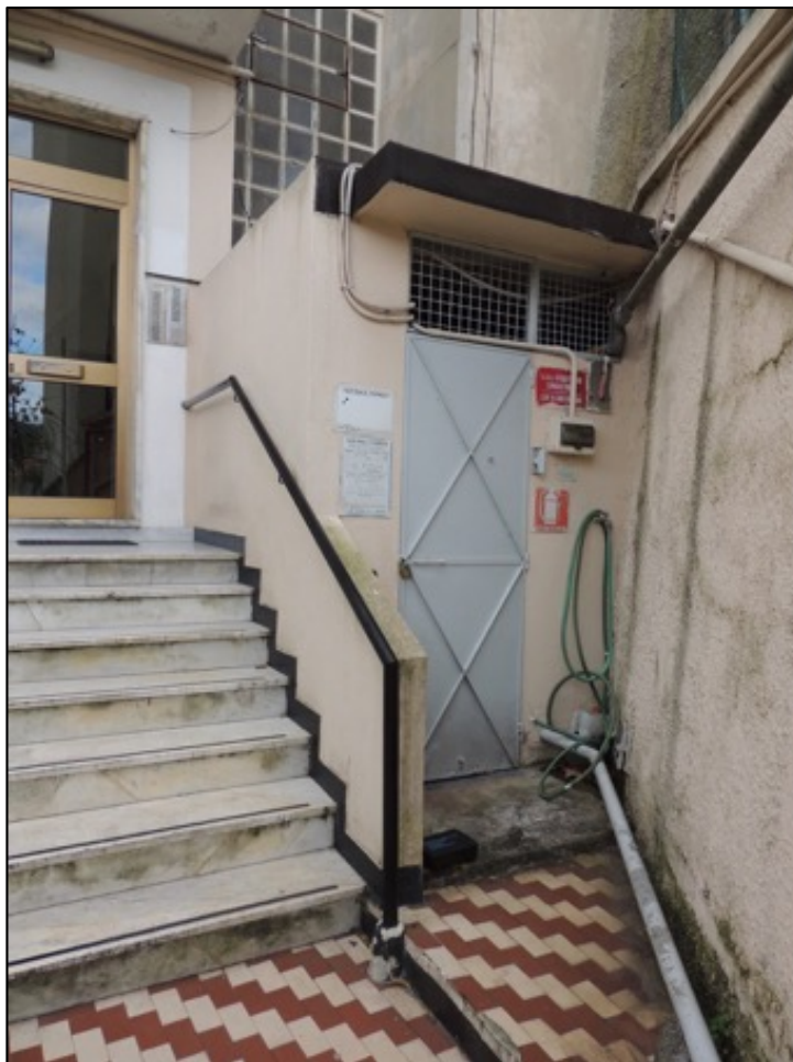
Foto 15 – accanto al portone di accesso del civ.39 è situata la centrale termica in condivisione con il civico 39 B soprastante;
