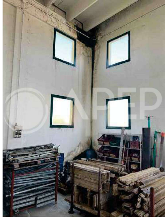
Vista INFILTRAZIONE (NEGOZIO-MAGAZZINO)
