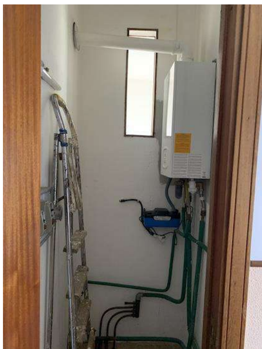
Foto 37: RIPOSTIGLIO CON CALDAIA
