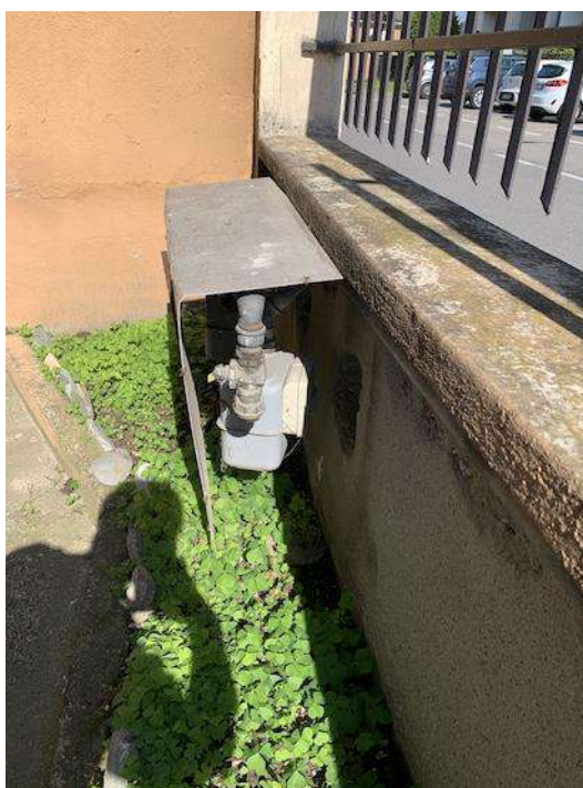
Foto 4: CONTATORE LATO STRADA
