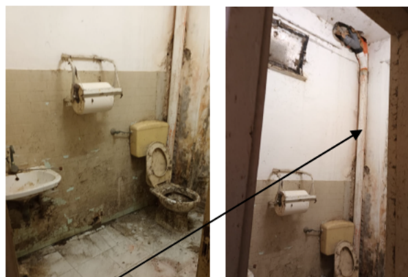
Colonna di scarico del sovrastante appartamento
