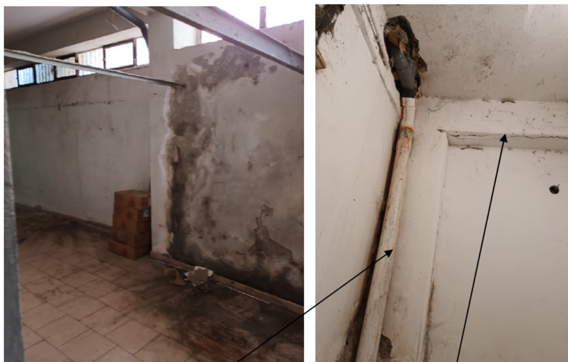
Bagno si noti la colonna di scarico che lo attraversa e le condizioni di ammaloramento della trave
