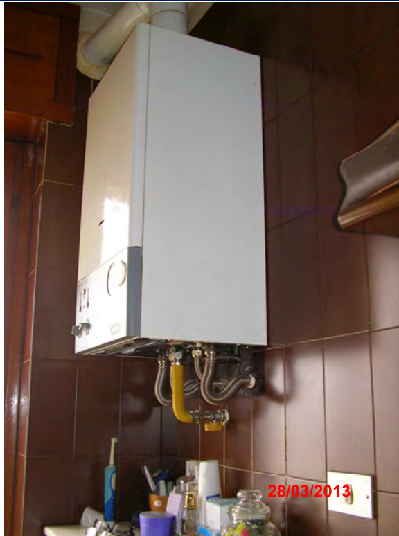
13 - Interno proprietà [REDACTED]: caldaia (2)
