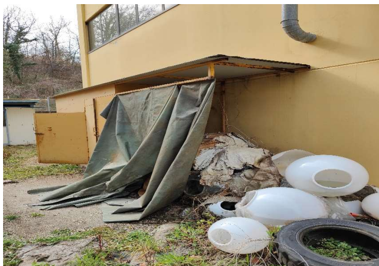
Foto 20- Porzioni da demolire per mancanza di autorizzazioni
