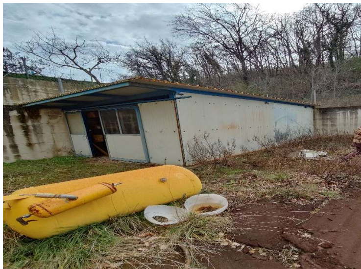
Foto 19- Porzioni da demolire per mancanza di autorizzazioni
