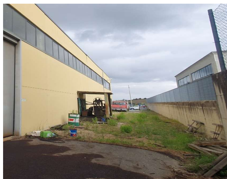
Foto 21- Porzioni da demolire per mancanza di autorizzazioni
