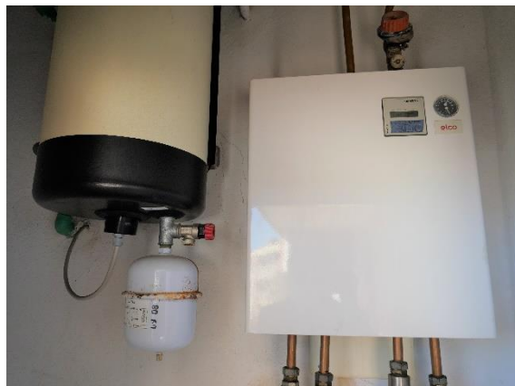
Caldaia e boiler solare
