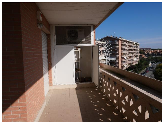
Balcone lato locale motore aria cond.
