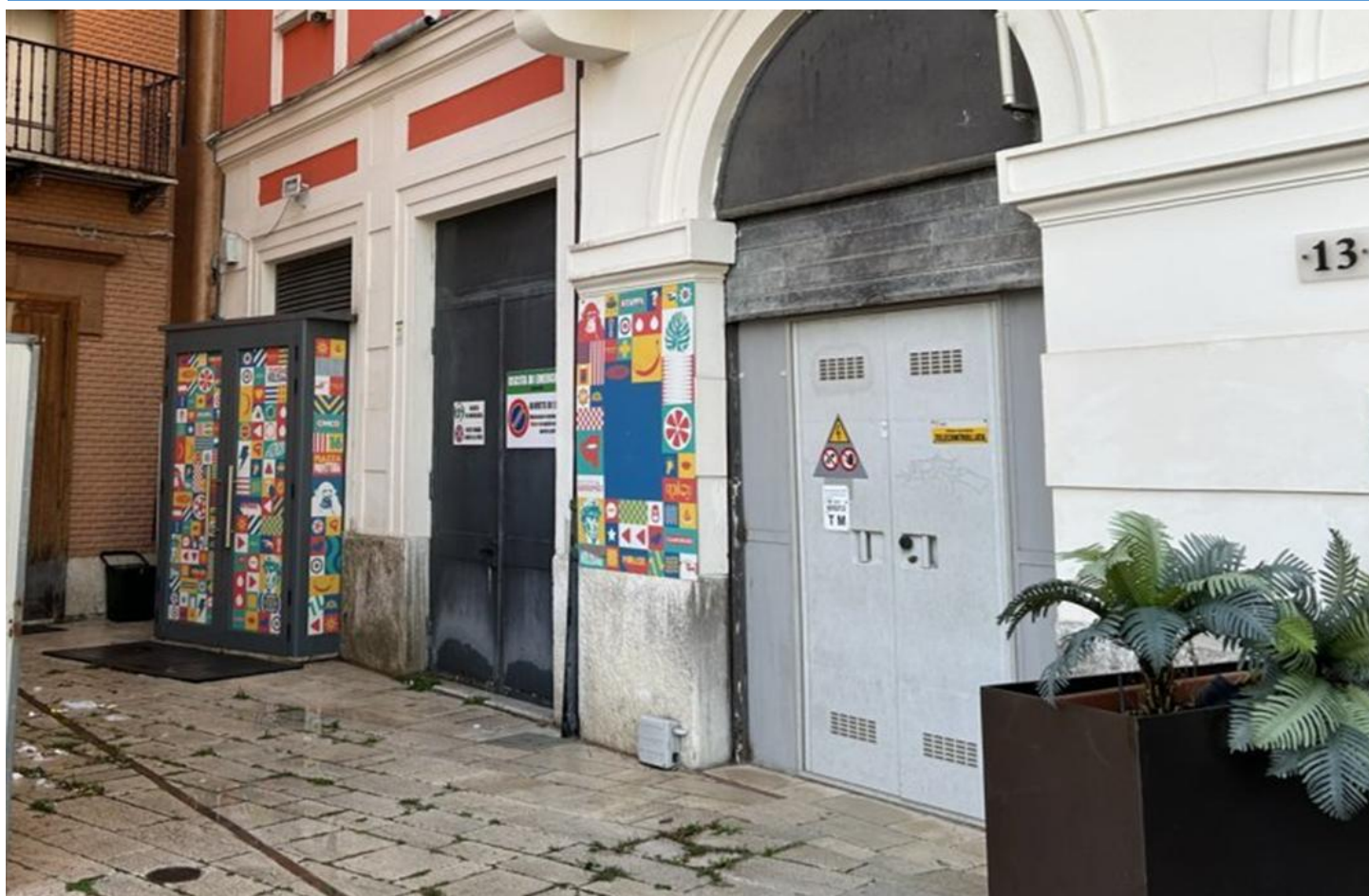
cabina elettrica - Piano terra sub.69
