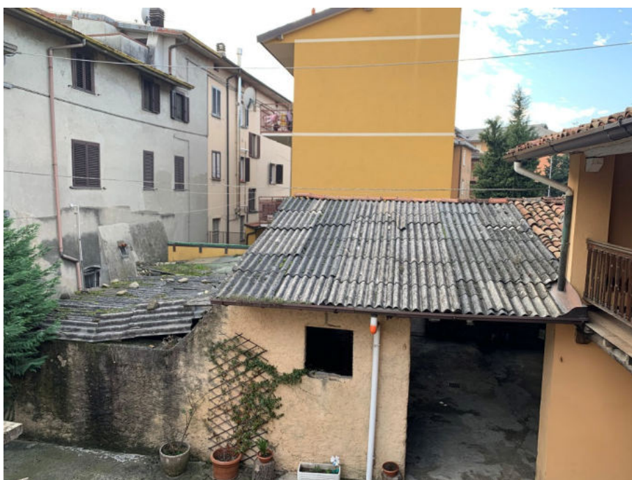
Box e magazzini hanno una copertura in eternit da smaltire
