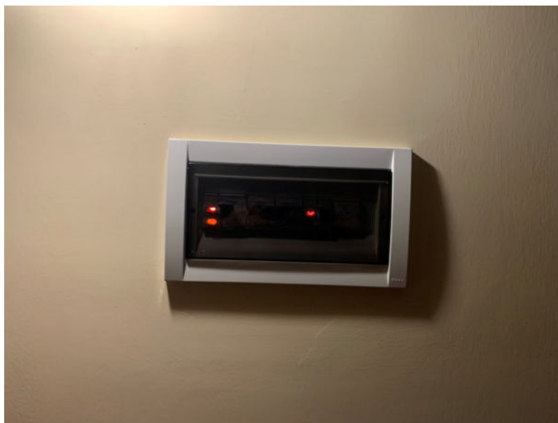
Impianto elettrico appartamento funzionante quadro elettrico
