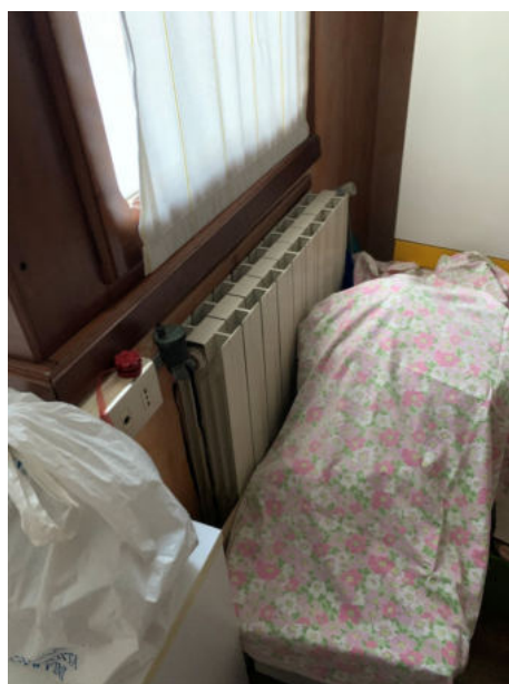
Impianto di riscaldamento autonomo caldaia posta nel cavedio e corpi riscaldanti
